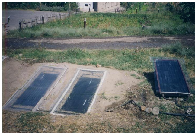
Рис. 2. Общий вид грунтового солнечного водонагревательного коллектора
