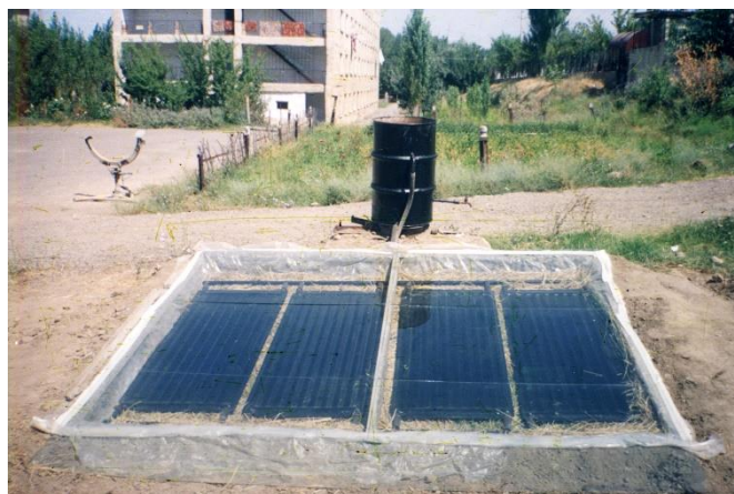
Рис. 3. Общий вид солнечной водонагревательной установки
